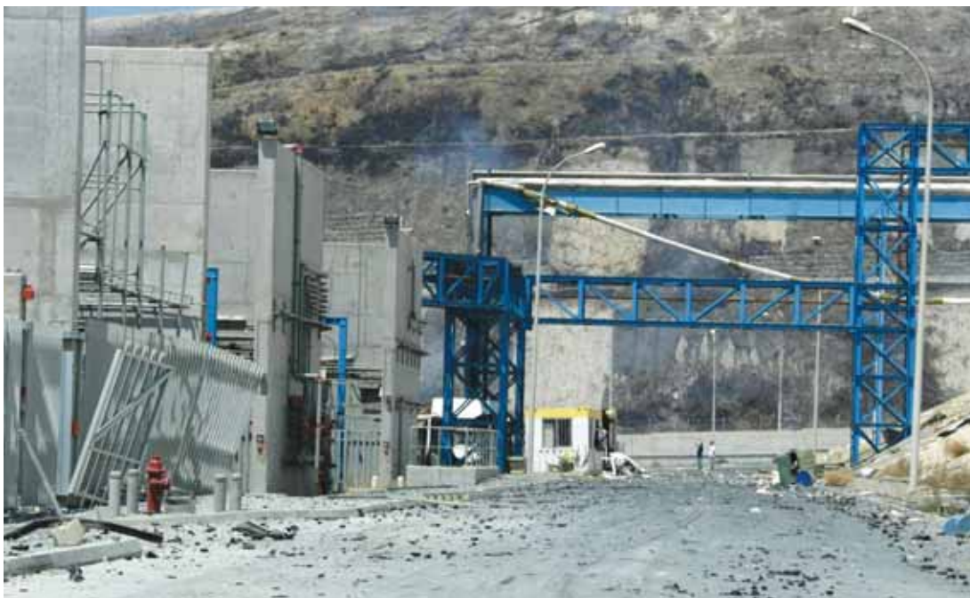
Η καταστροφή του ηλεκτροπαραγωγού σταθμού στο Βασιλικό ήταν πλήρης με όλα τα γνωστά αρνητικά επακόλουθα
